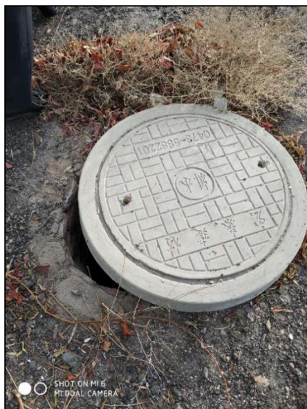
碱柜站渗水井
